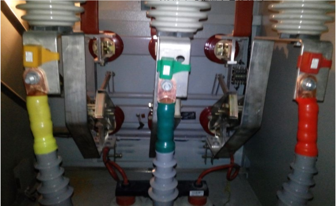
无线温度采集器在出线电缆与铜排压接处的安装
