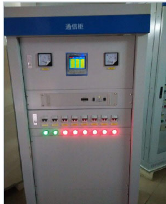
无线测温汇集终端安装于 通信柜面板
