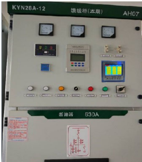
无线测温汇集终端安装于 开关柜面板
