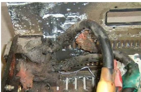
电缆接头高温熔化
